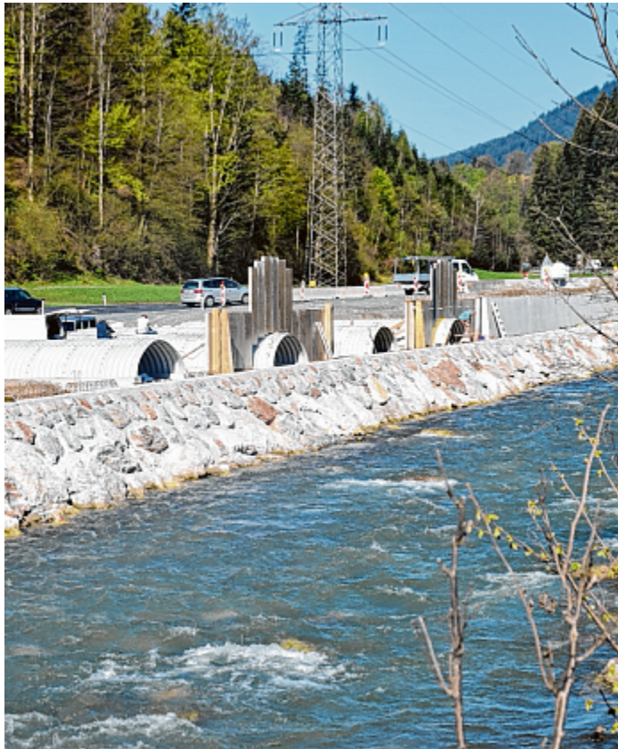
Die Reither Ache wurde für den Hochwasserschutz teilweise verrohrt, drei Bauern werden mit 2,3 Millionen Euro entschädigt.
